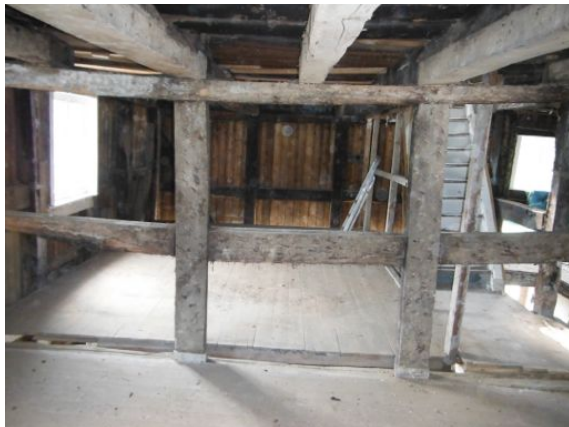
Verformungen des Tragwerks / Überbelastung aus Dachboden
