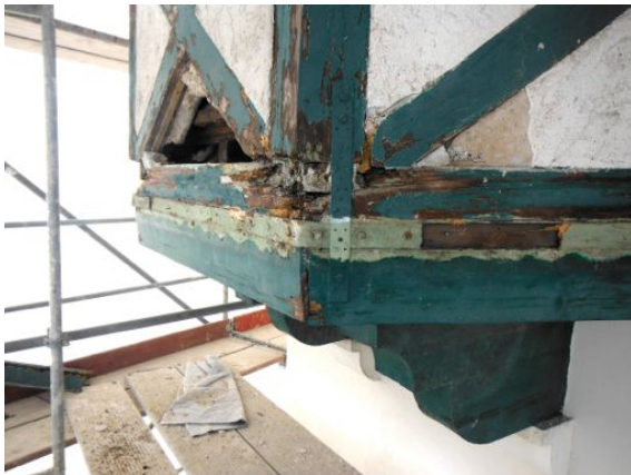
Vermorschungen am Erker-Fachwerk | Dampfdichte Beschichtungen - abgesenkte Erkerkonstruktion -
