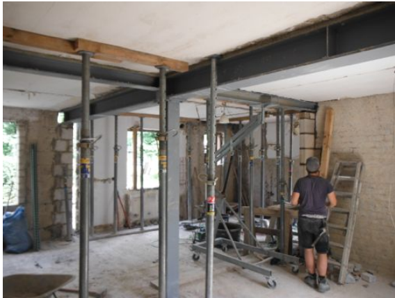
Stahlstütze | Stahlträger als Ersatz für tragende Innenwände Stahlstürze für neue Fenster- und Türöffnungen
