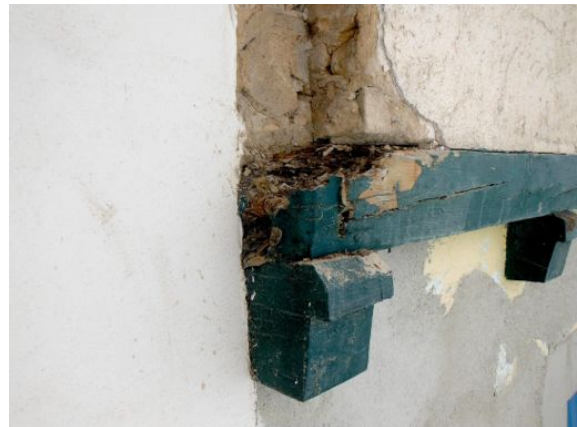
Vermorschungen an der Schmuckfassade - abgesenkte Konsolen -
