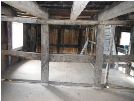
Verformungen des Tragwerks / Überbelastung aus Dachboden
